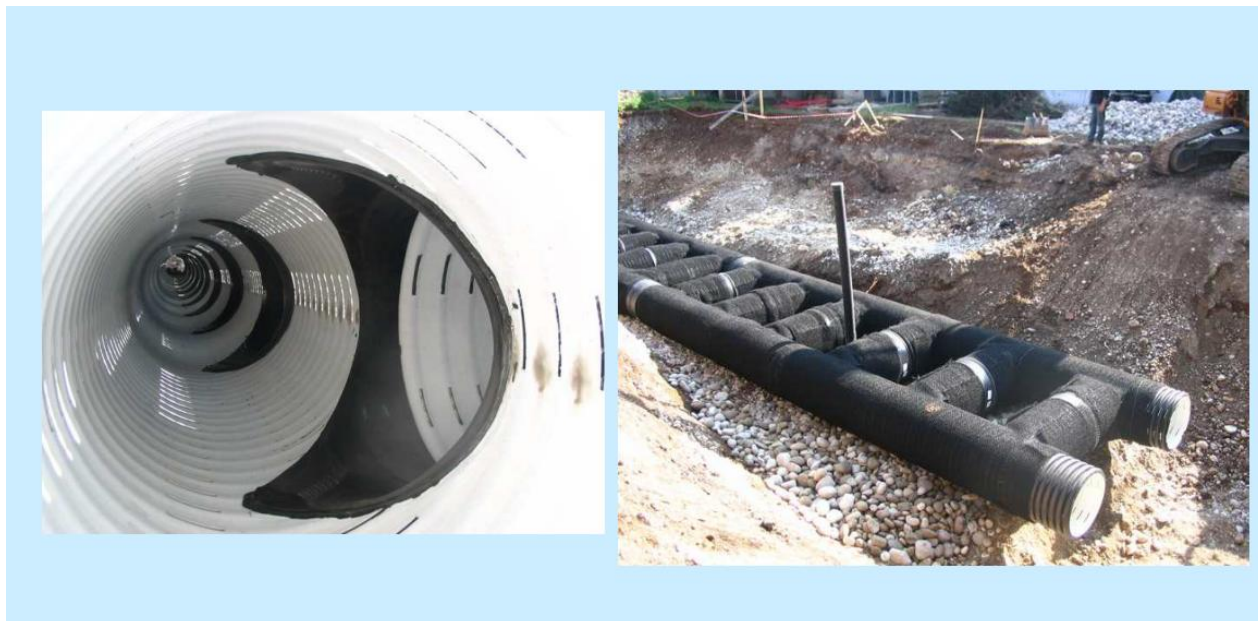
Tubi corrugati in polietilene fessurati per il contenimento dei volumi d'acqua
